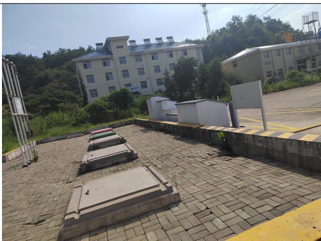
加油站油罐区
